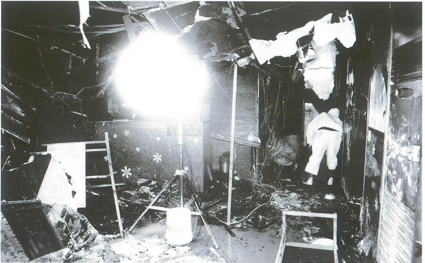
지난 5일 밤 8시52분께 부산 부산진구 부전동의 한 노래주점에서 불이 나 손님 9명이 숨지고 25명이 부상을 당하는 참사가 벌어졌다. 이번 화재는 노래방의 복잡한 내부 구조가 피해를 더 키운 것으로 드러났다. 6일 오전 화재현장에서 경찰, 국과수, 소방당국 등으로 구성된 합동감식반이 정밀감식 작업을 하고 있다. /뉴스시스
