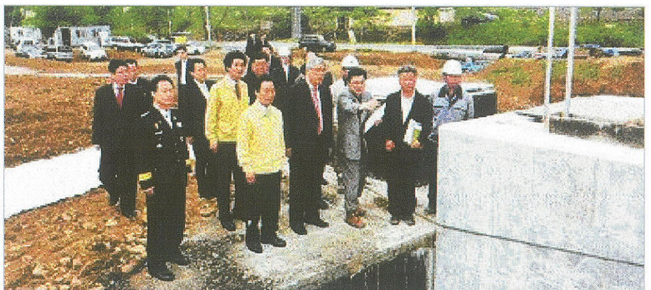
소방방재청 이기환 청장이 지난 3일 경북 청도에 공사 중인우수저류시설 설치 현장을 점검했다.
