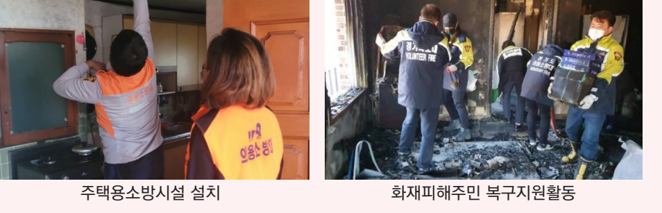
주택용소방시설 설치 화재피해주민 복구지원활동
