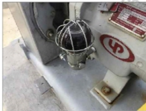
[구동장치 회전부 급유상태 점검]
